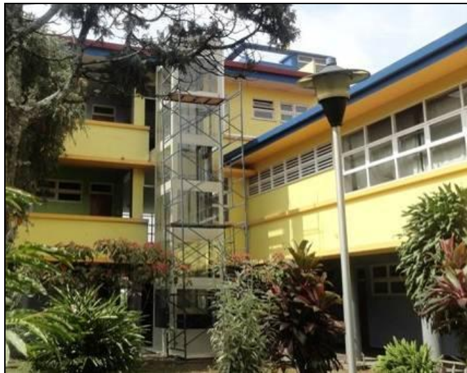
El recientemente instalado ascensor en la escuela
